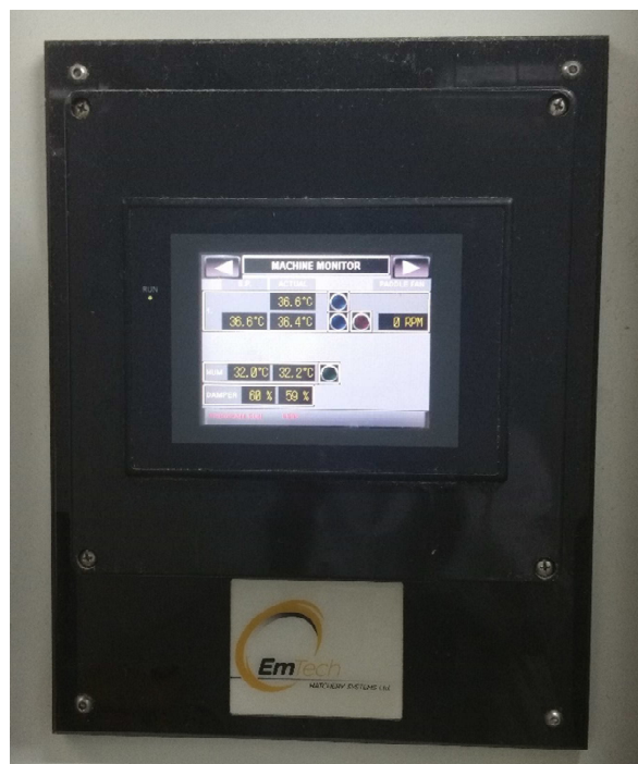
Figura nr. 20. Sistem automat de monitorizare și reglaj a parametrilor din eclozionatoare
