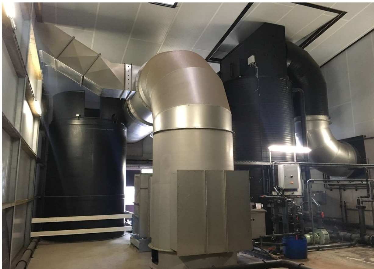
Figura 7. Tratarea emisiilor și mirosurilor cu scruber cu amoniac și rezervor de stocare a sulfatului de amoniu
