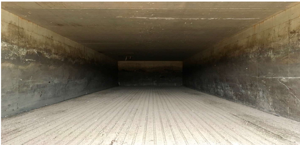
Fig.4 – Interiorul reactorului de compostare.
