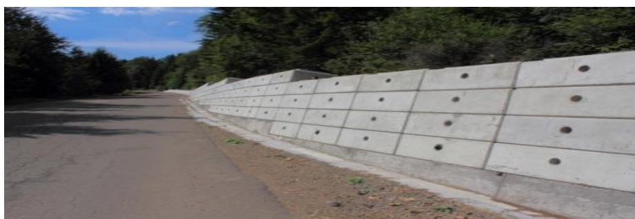
Fig.V.1.4.1.3. Parapet din beton lângă DN 2D, barieră absolută pentru lup
