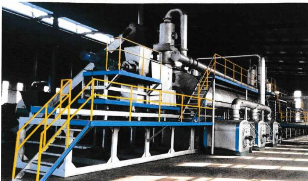
Figura 4. Imagine de ansamblu instalație
