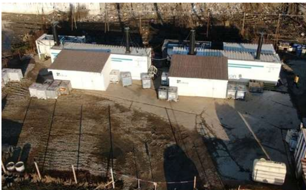
Figura nr. 4-1 Stația de epurare levigat
