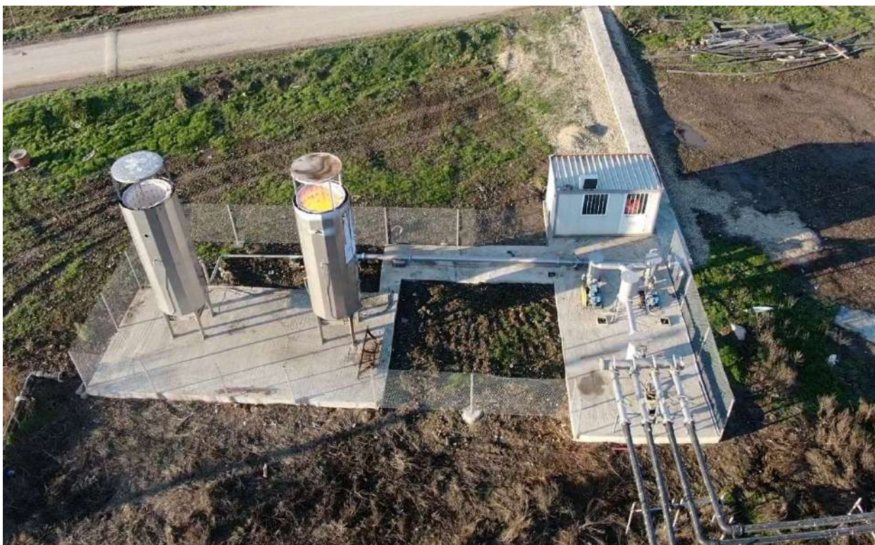
Figura nr. 2-3 -1 Instalatie de ardere controlata a gazului de depozit
