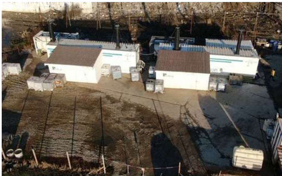
Figura nr. 4-1 Stația de epurare levigat
