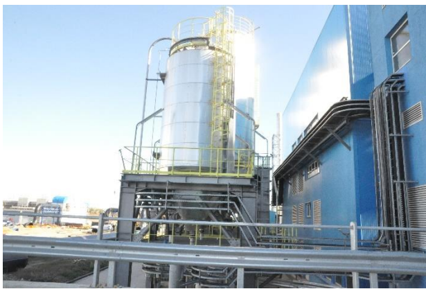
Zona de depozitare a cenușii în silozuri
