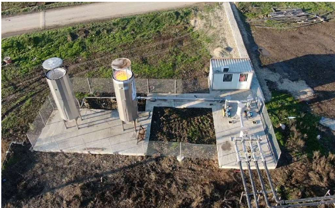
Figura nr. 2.5 Instalatie de ardere controlata a gazului de depozit
