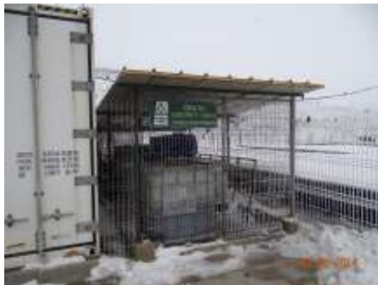
Figura nr. 2-3 Zona depozitare substanțe utilizate la curățarea stației de epurare
