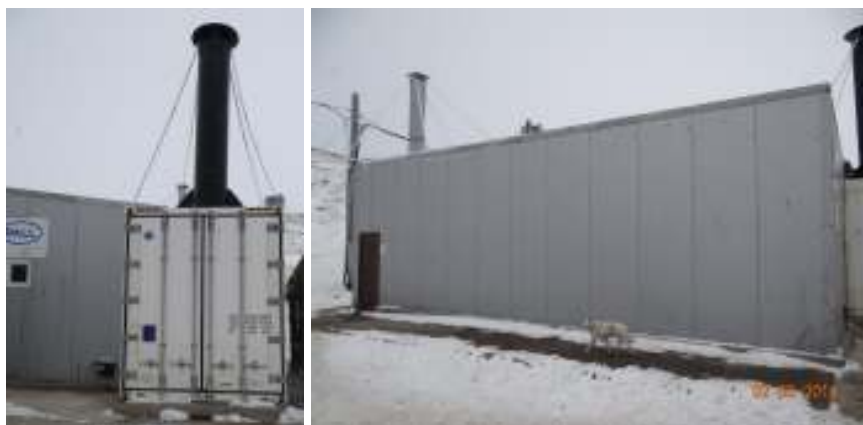
Figura nr. 4-1 Stația de epurare levigat PALL Austria Filter (stânga containerul stației, dreapta incinta de depozitare a rezervorului de acid sulfuric)
