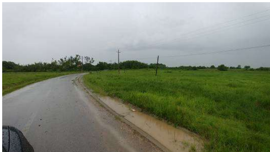
Fig. 5. Datorita colmatari podetelor la drumurile laterale apa pluviala balteste in santurile existente - zona km 0+650
