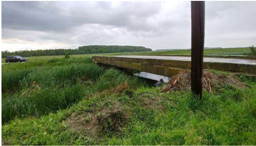
Fig. 7 . Pod cu fasii cu goluri din beton de ciment la km 0+695 - face obiectul altei expertize de specialitate
