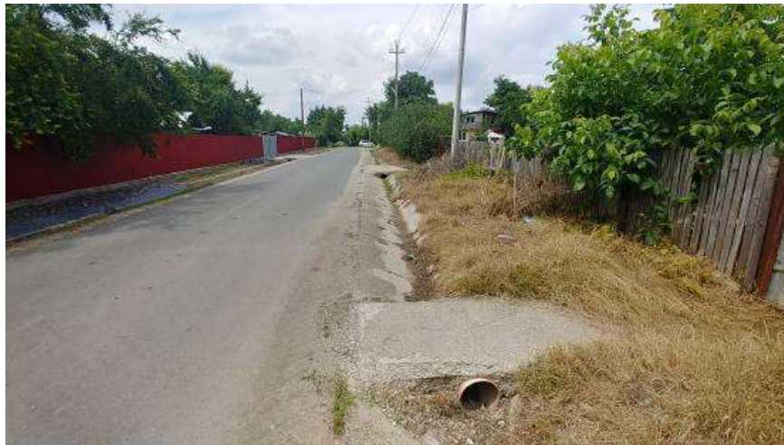
Fig. 4 . Partea carosabila si santuri existente in stare tehnica relativ buna, in intravilanul comunei Sitaru. Se observa lipsa trotuarelor
