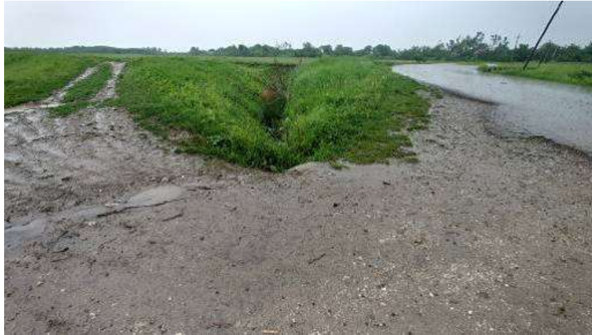
Fig 6 . Podet partial colmatat si fara timpene la km 0+678
