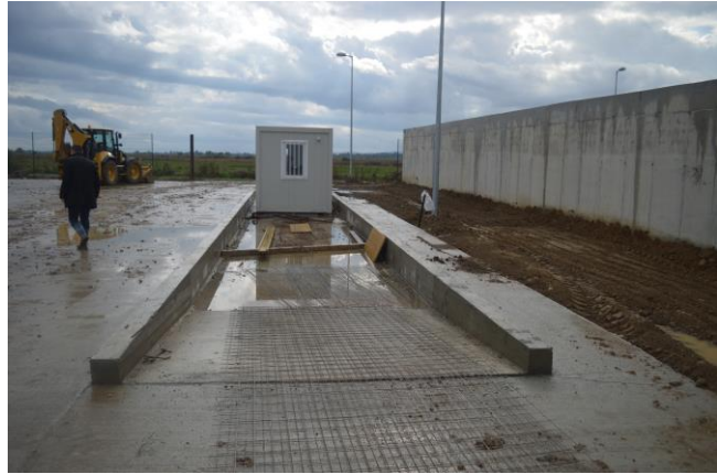
Figura nr. 10 - Rampa de spalare autovehicule
