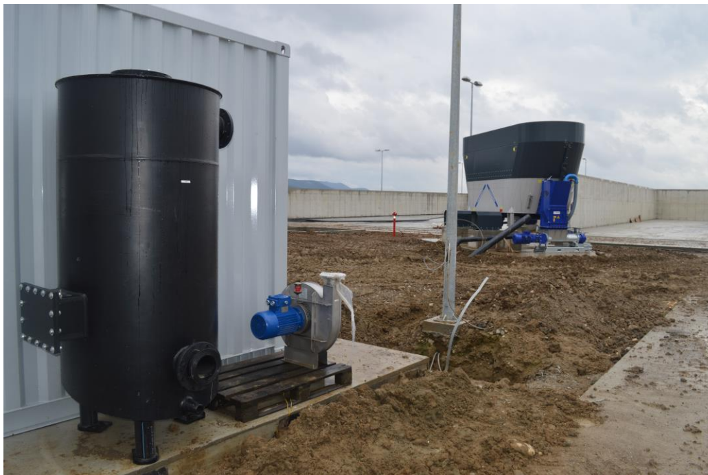
Figura nr. 15 - Filtru carbune pentru desulfurare și alimentator
