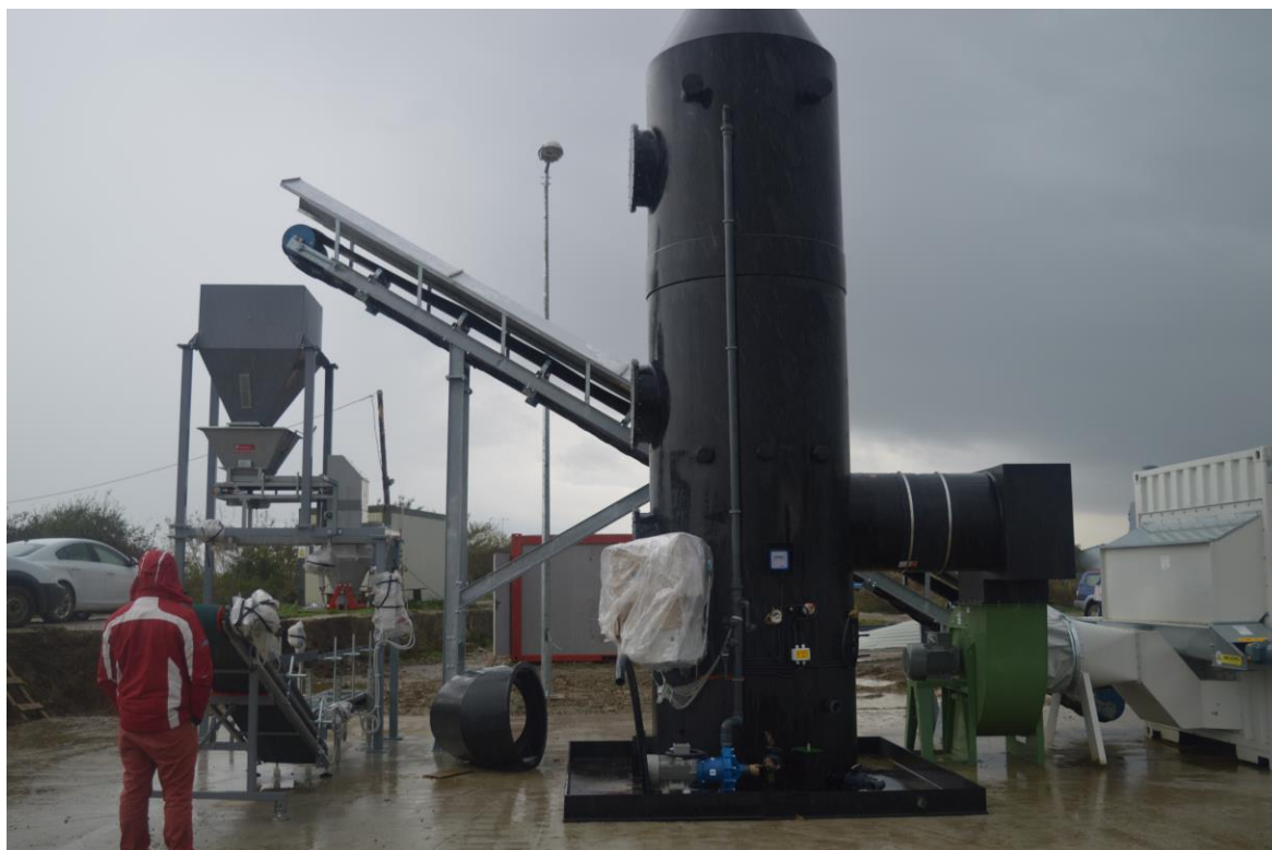
Figura nr. 19 - Ansamblu scruber, bada transport digestat uscat și instalație înșăcuire.
