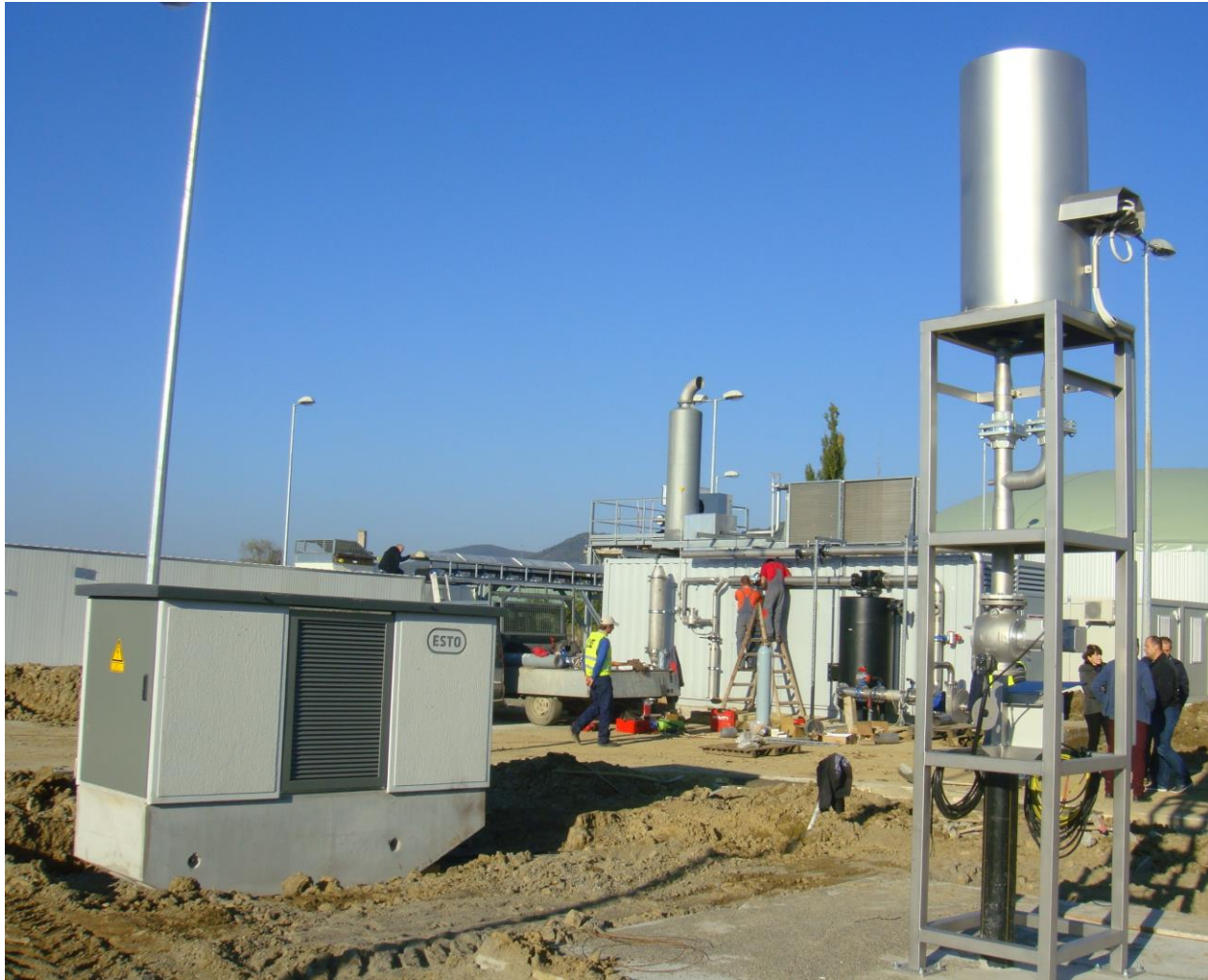
Figura nr. 20 - Ansamblu transformator, unitate de cogenerare, facla
