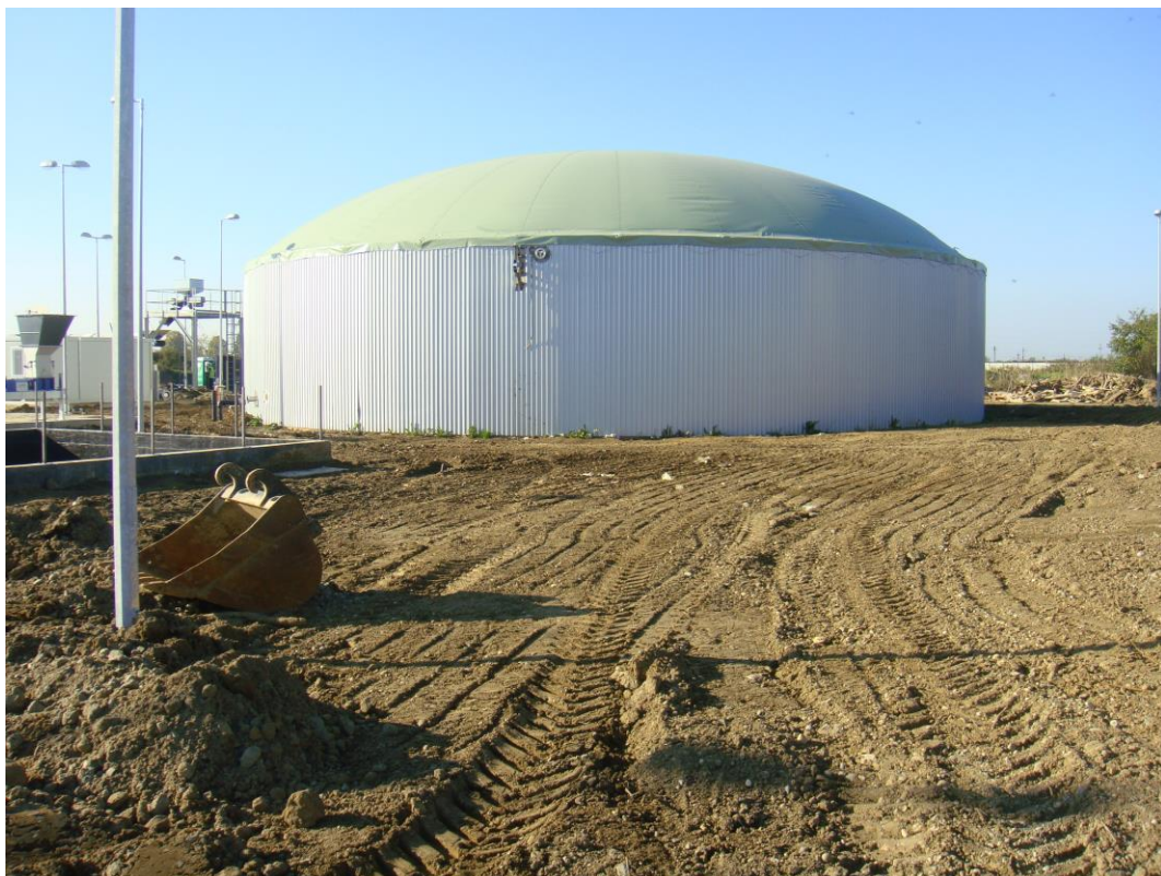
Figura nr. 12 - Digester anaerob
