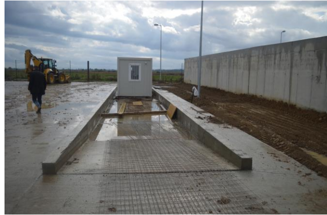
Figura nr. 10 - Rampa de spalare autovehicule
