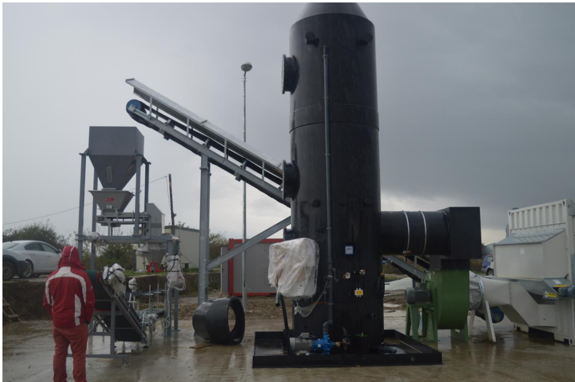
Figura nr. 19 - Ansamblu scruber, bada transport digestat uscat și instalație însăcuiere.
