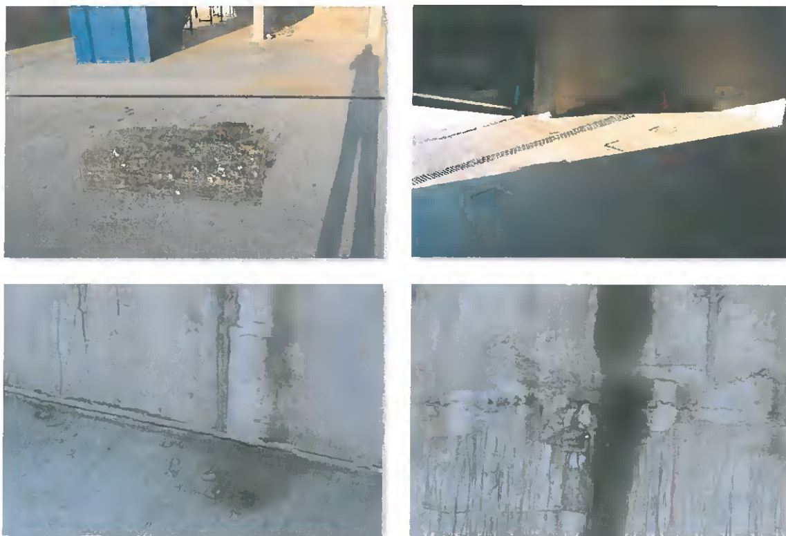
Fig. 15 – Detalii de degradare a construcțiilor de pe amplasamentul Stației TMB Sârbi
