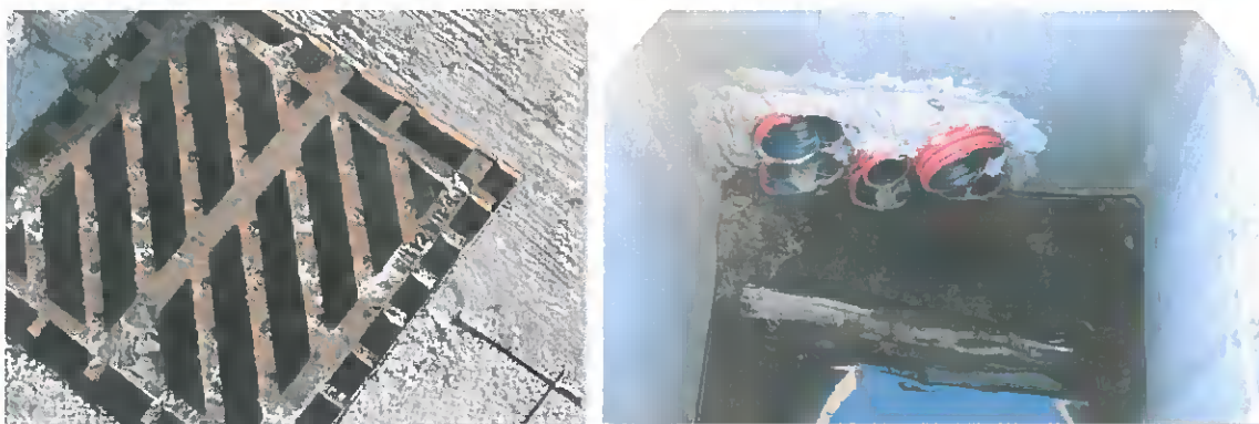
Fig. 3 – Detalii ale sistemului de drenaj ale platformei CMID pe care este amplasată Stația TMB
