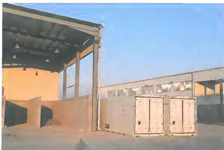
Fig. 13 – Containerele stației de epurare prin osmoză inversă propuse a fi date în folosință în etapa de modernizare a Stației de tratare mecano-biologică Sârbi
