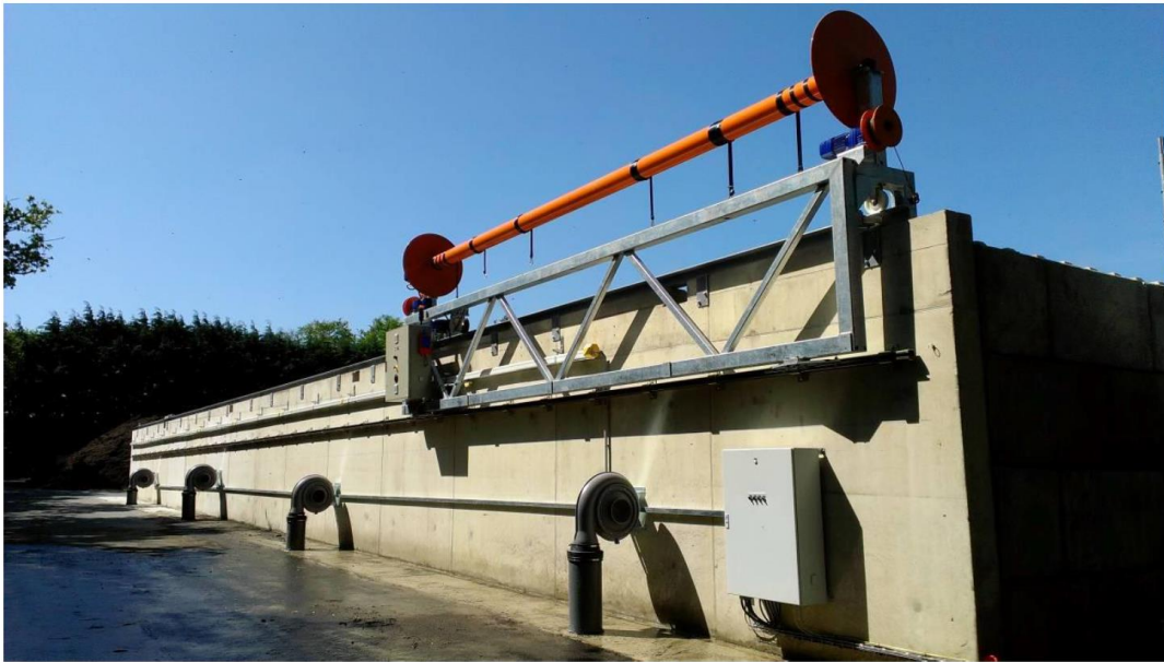
Figure 10-12 – Exemplu de stație de compostare din Ungaria.
