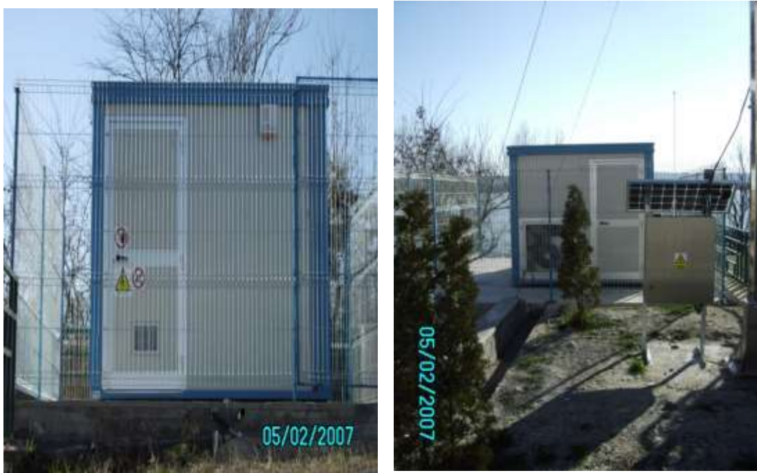
Figura nr. I.1.1.1 - Stația fixă automată MH1
