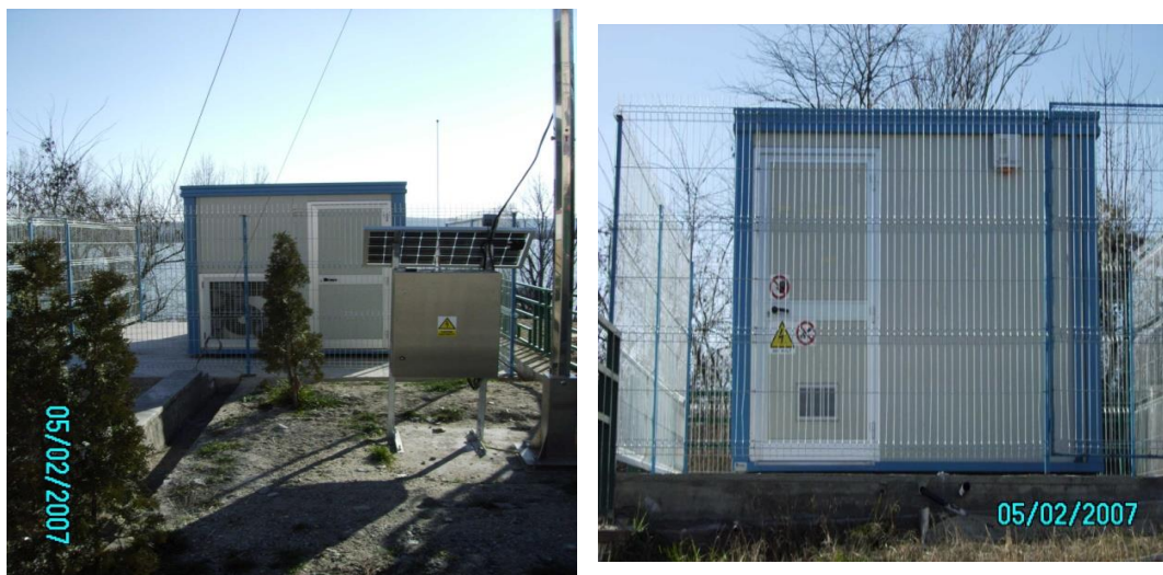
Figura nr. I.1.1.1 - Stația fixă automată MH1
