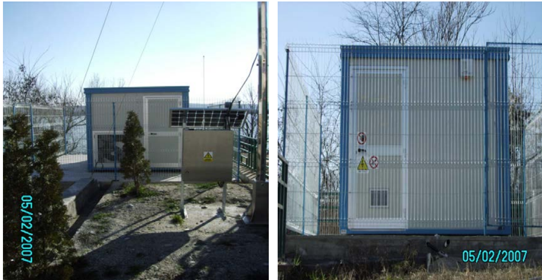
Figura nr. I.1.1 - Stația fixă automată MH1
