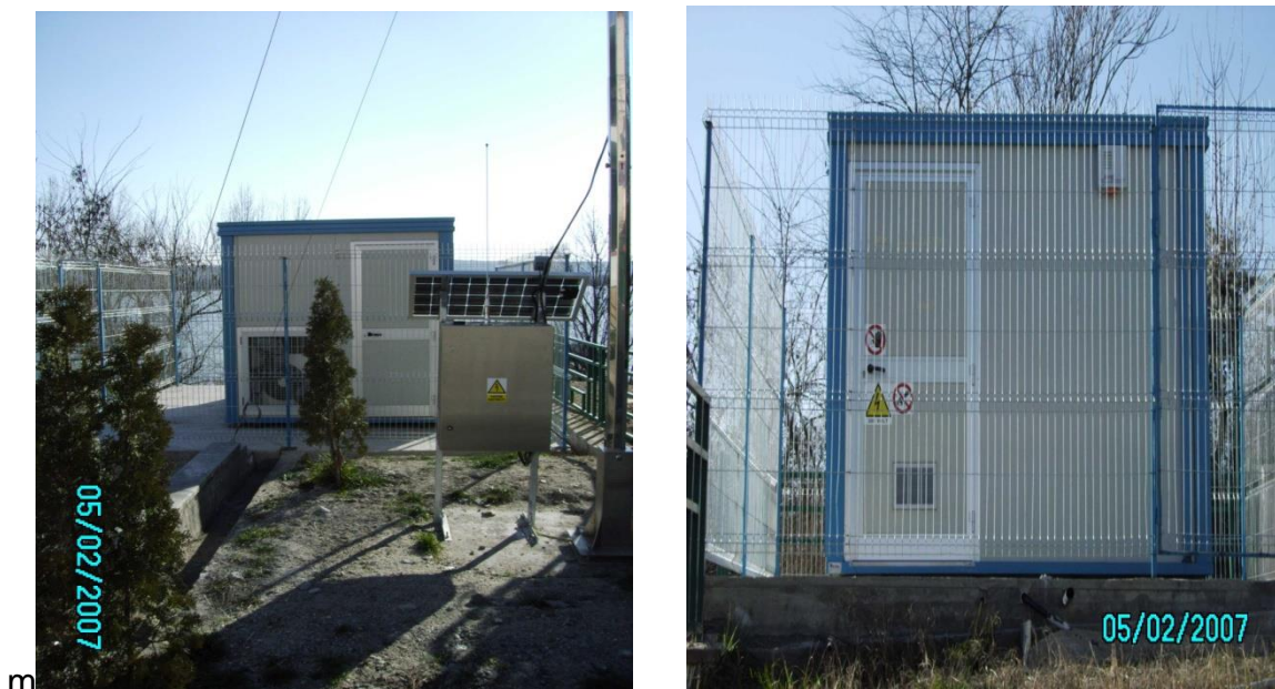
Figura nr. I.1.1.1 - Stația fixă automată MH1
