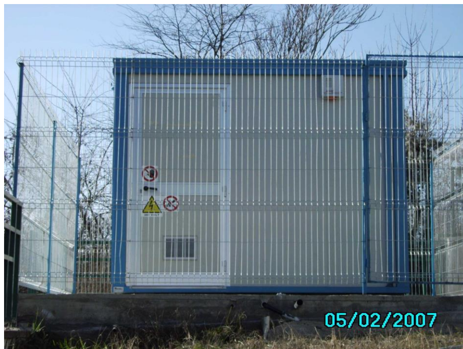
Fig nr.2- Stația fixă automată MH1
