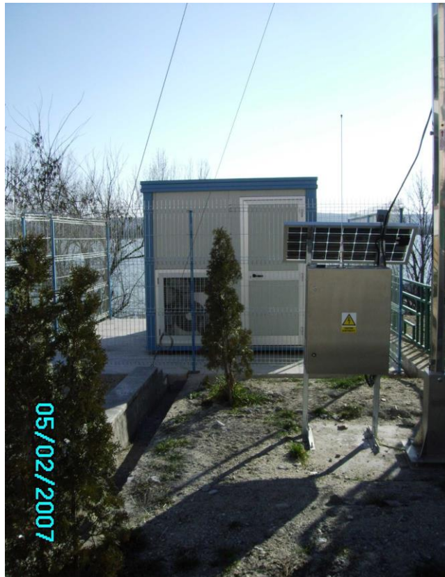
Fig nr.1-Stația fixă automată MH1
