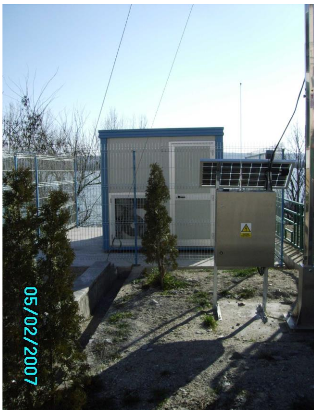
Fig nr.1-Stația fixă automată MH1
