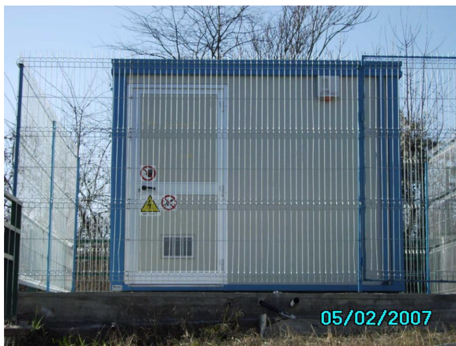
Fig nr.2- Stația fixă automată MH1
