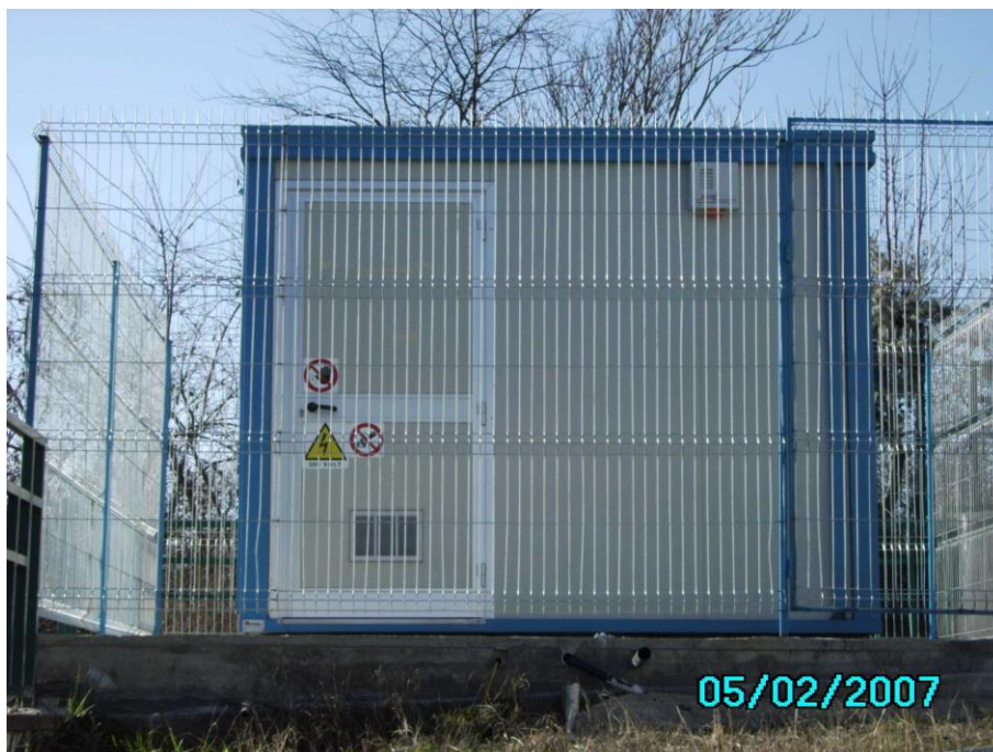
Fig nr.2- Stația fixă automată MH1
