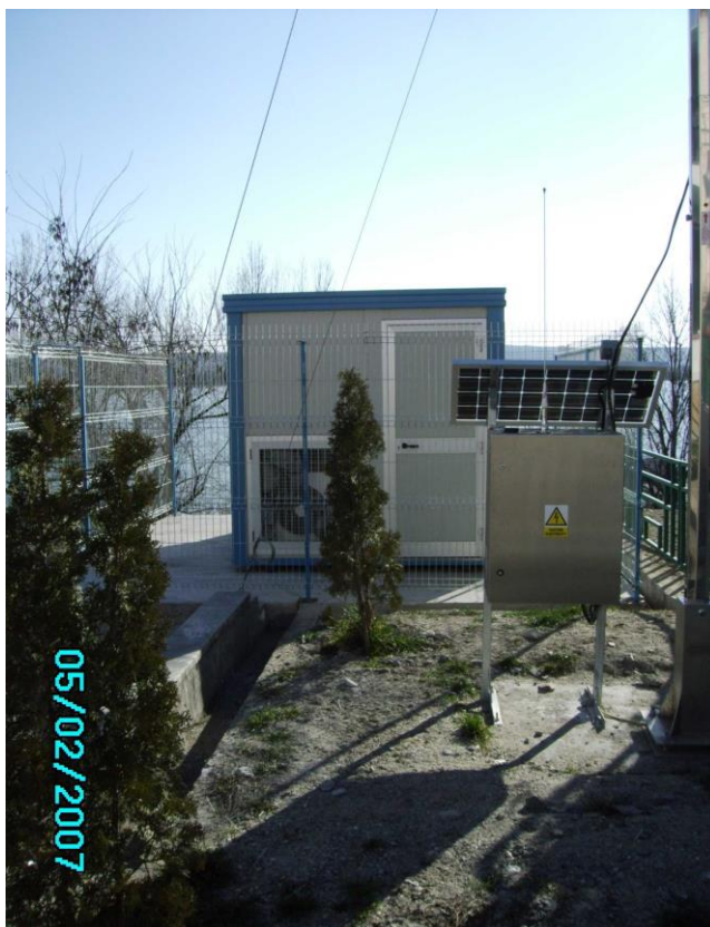
Fig nr.1-Stația fixă automată MH1
