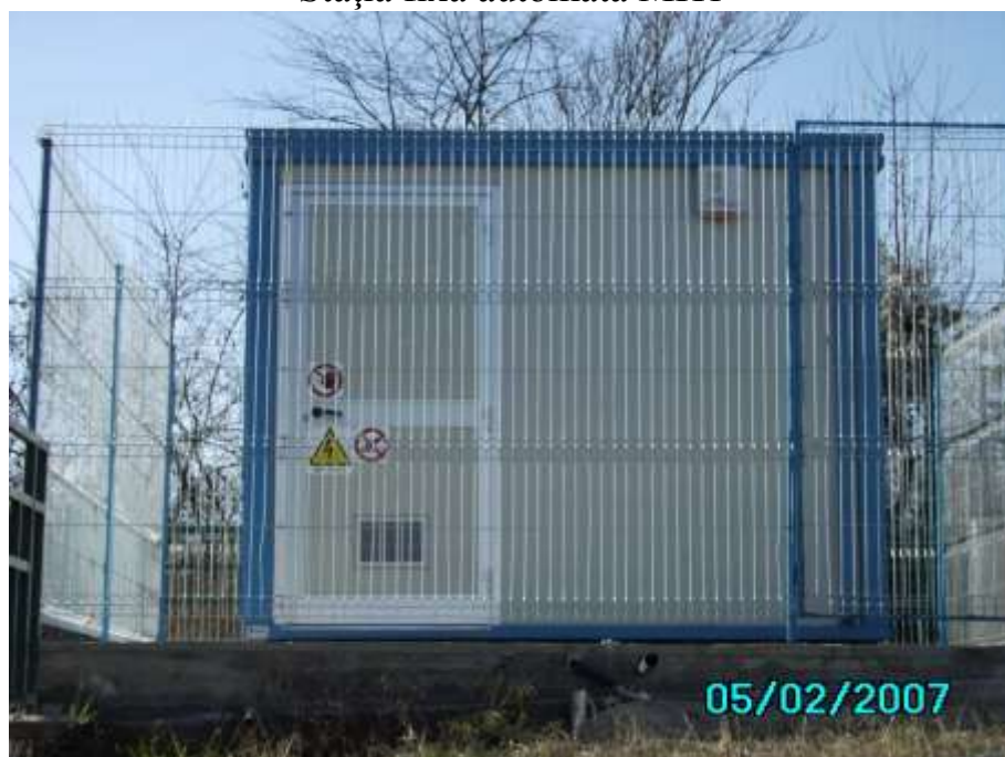
Stația fixă automată MH1
