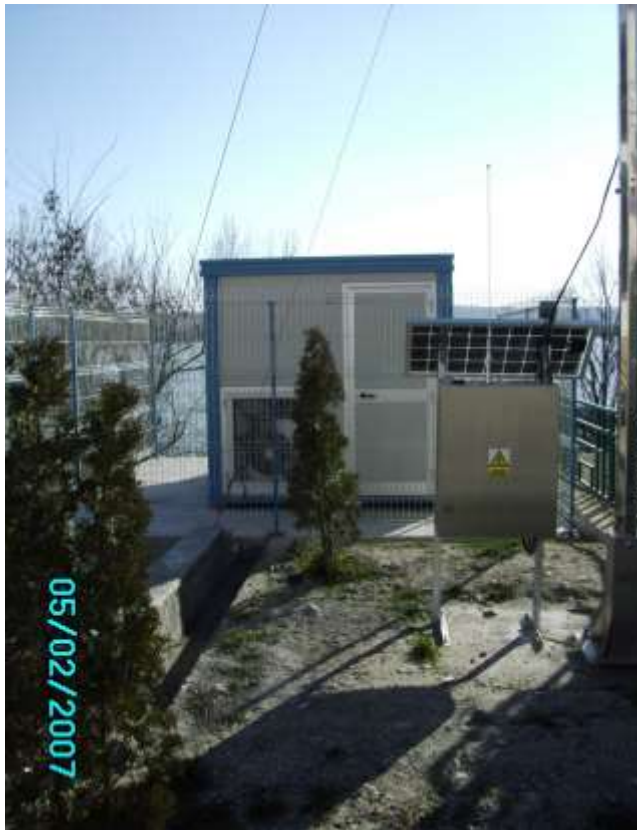
Stația fixă automată MH1
