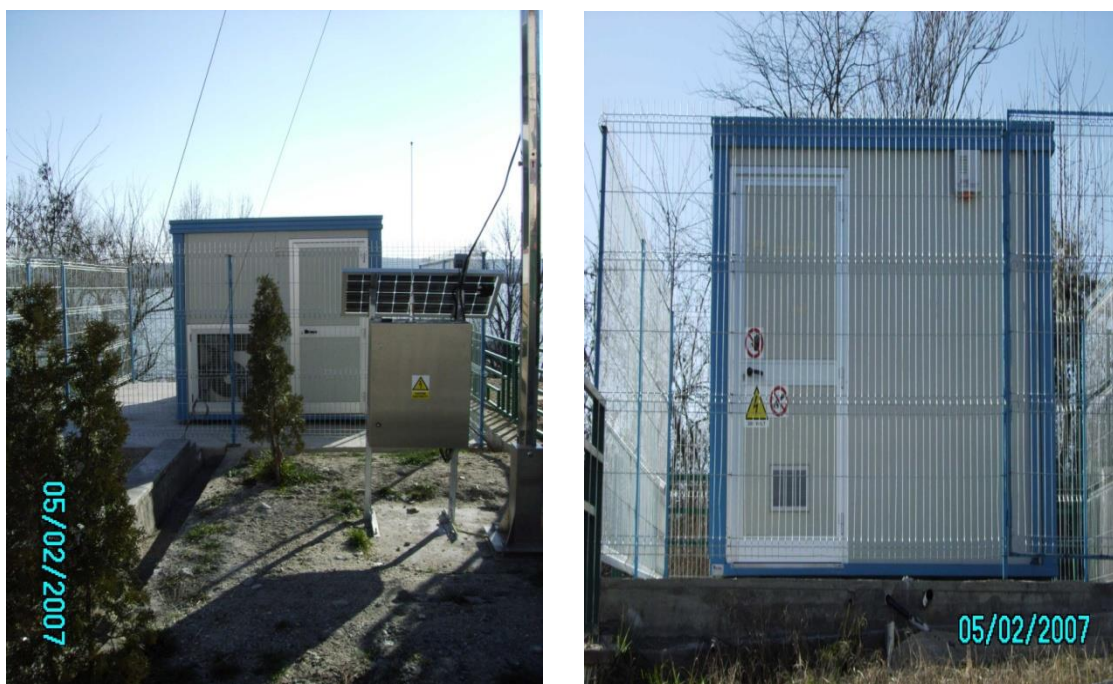
Figura nr. I.1.1. - Stația fixă automată MH1
