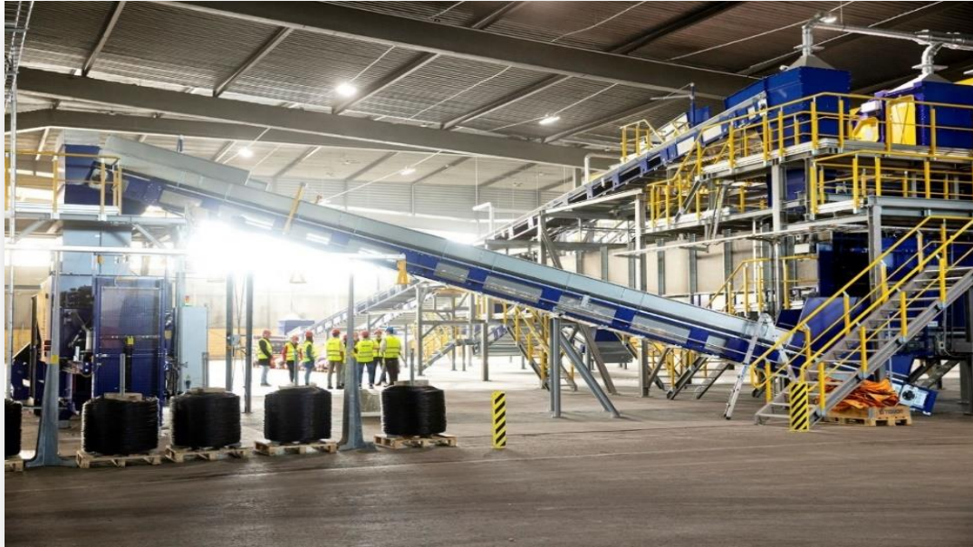
Fig. 3.5 - Imagine de ansamblu a unei Stații de sortare mecanică
