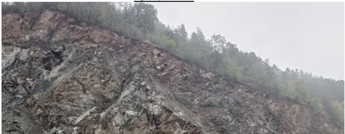
Figura 25. Aspect de la nivelul amplasamentului operat de SC Clarimar Impex SRL. Se observă absența stratului de copertă pe unele porțiuni, roca ieșind la suprafață
