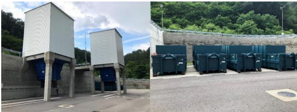
Figura nr. 15 –Stația de transfer Orșova
