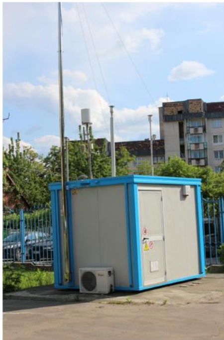
Fig.27 Stație de monitorizare a fondului urban MS-1.
