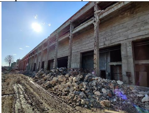
Corp C1.6- Hală ventilație
