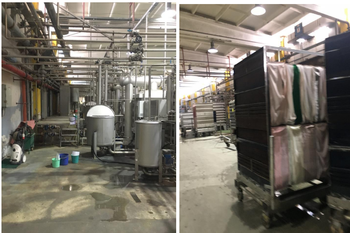
Aspecte din secția Vopsitorie
