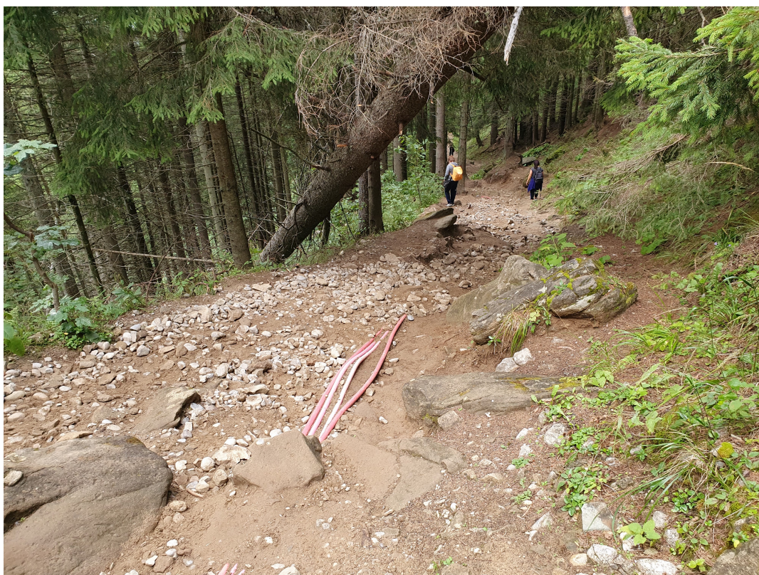
Foto 5. Aspect general al traseului LES 6 kV în cadrul habitatului 9410 (foto E. Stoianov)
