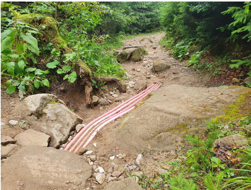
Foto 1. Aspect general al traseului LES 6kV în cadrul habitatului 9410 (foto E. Stoianov)
