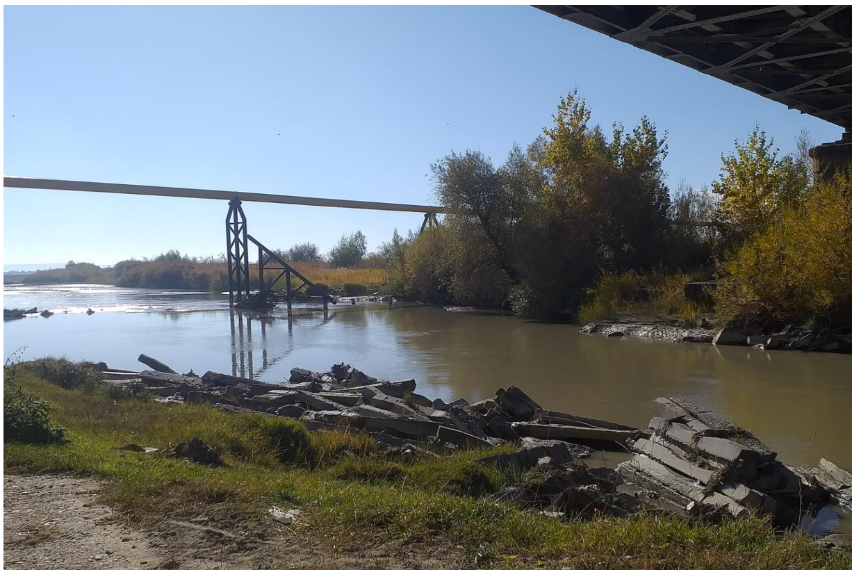
Figura - Albia râului Moldova aval de pod km.343+714 și conducta deținută de TRANSGAZ ce supratraversează albia râului
