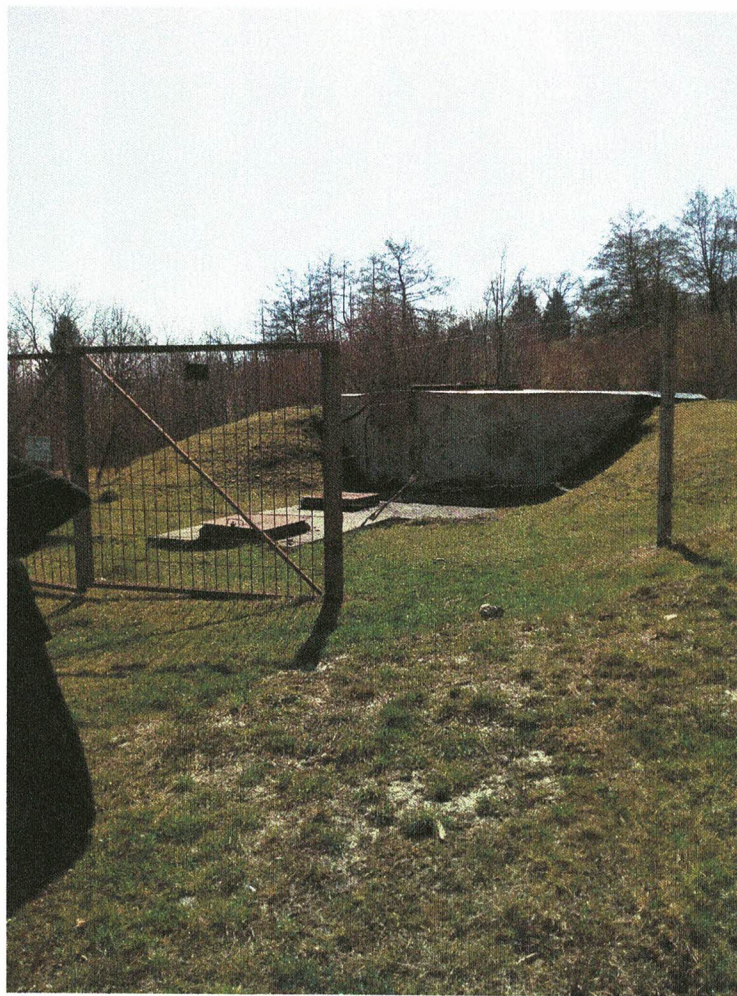
Rezervor 100 mc existent
