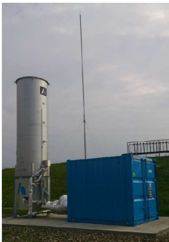
Foto nr. 13 – Sistemul de ardere a gazului
