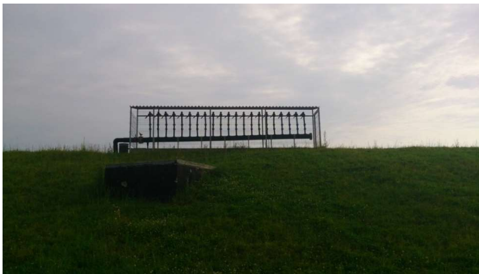
Foto nr. 12 – Substatia pentru gaz
