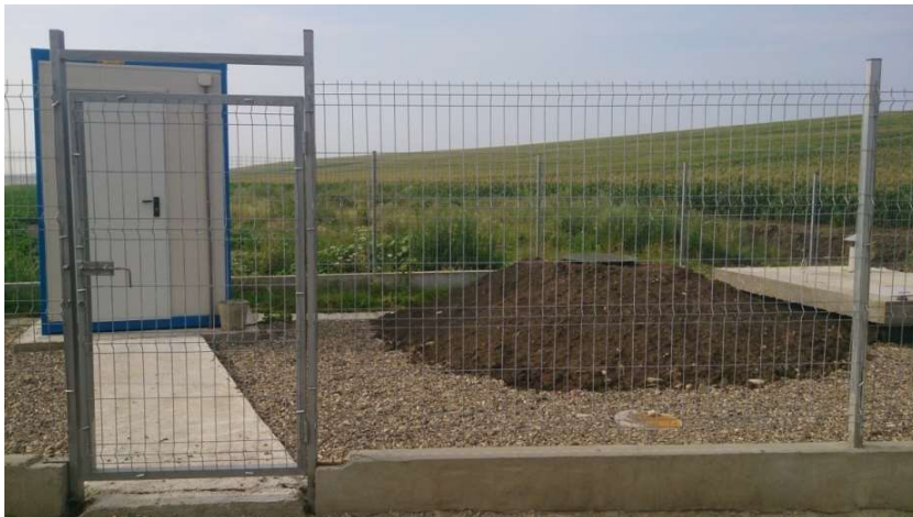
Foto nr. 9 – Statia de clorinare
