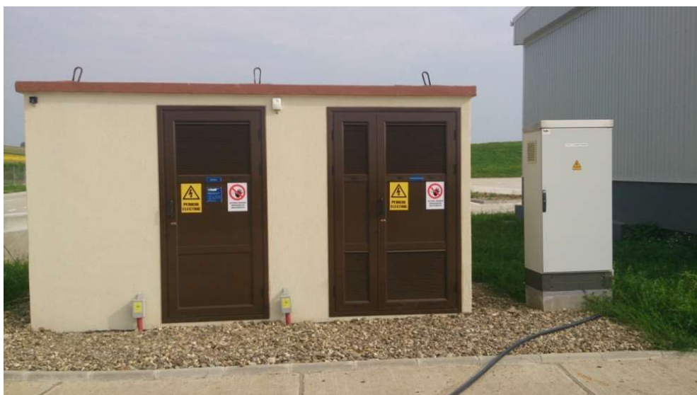
Foto nr. 14 – Post de transformare
