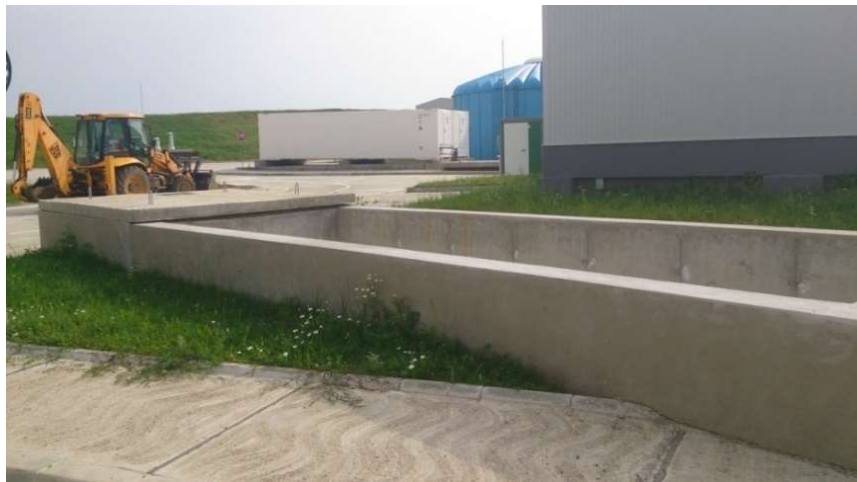
Foto nr. 16 – Decantor și separator de hidrocarburi
