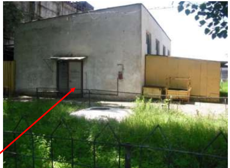
Stație de pompare
