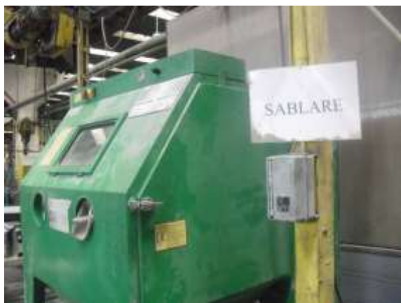
Fig.13. - Instalație de sablare cu alice din sticlă
