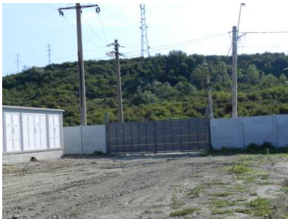
Fig. 5 – Poartă de acces intrare dinspre partea estică a amplasamentului – DN 546 și post trafa
