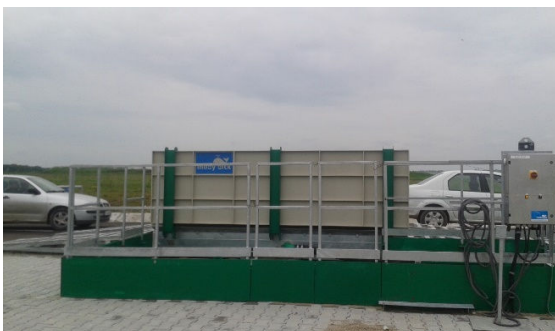
Echipament spălat roți
