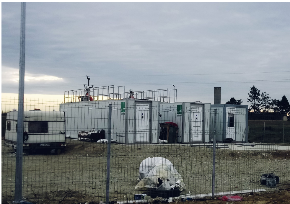
Imagine 1 – Stație de epurare (existentă) – Stoenești
