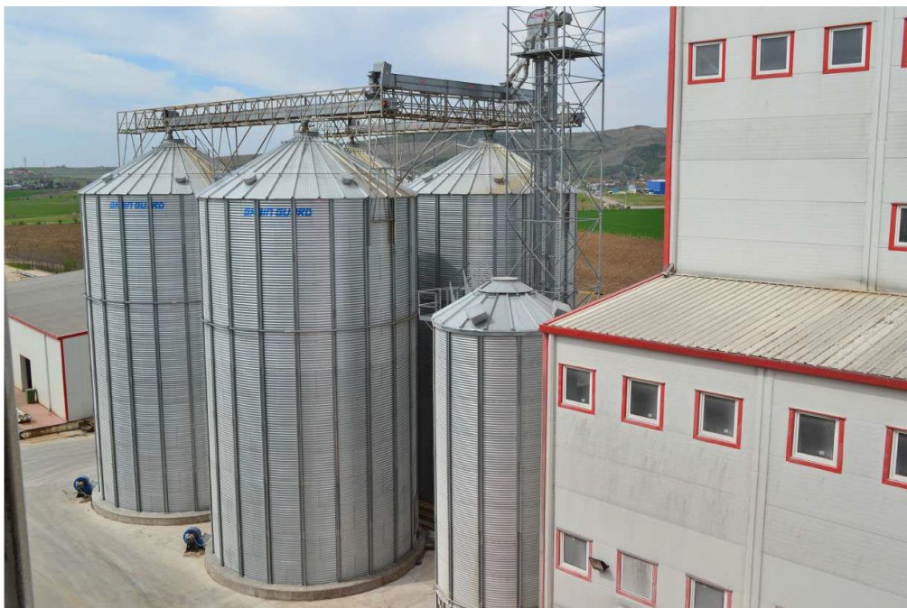
Figura 6: Silozuri de stocare
