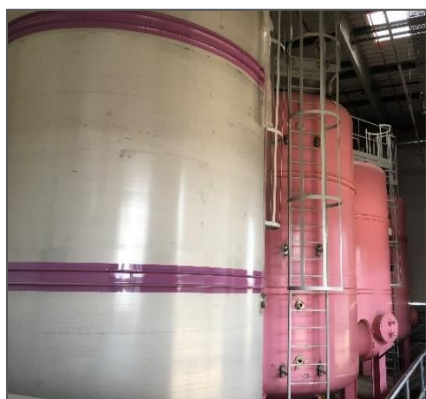
Rezervoare pentru stocarea rasinii si sulfatului de amoniu
