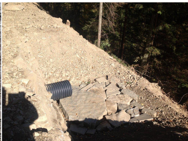
Fig. 11. Radier aval podeț tubular
