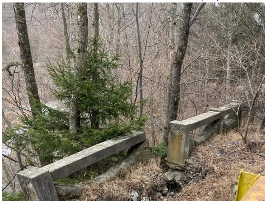
Imagine fotografica nr.1 – Zid si fundatie de parapet din zidărie de piatra si parapet din beton armat foarte degradat
