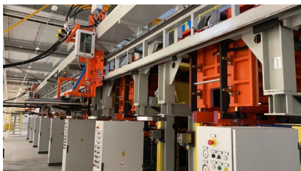
Poza instalatie spumare
