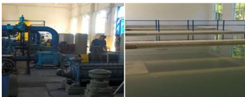
Fig. 14. Stația de tratare a apei potabile Voila-Câmpina 14
