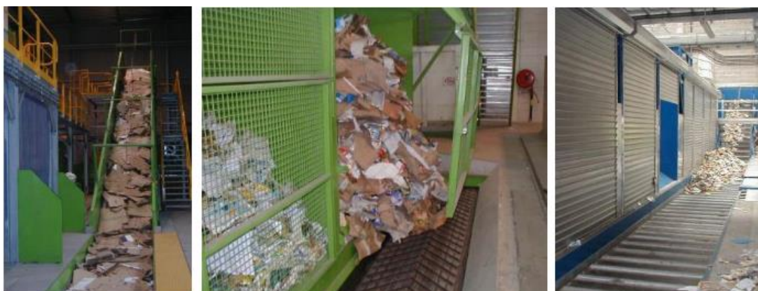
Figura 28 Silozuri, benzi de alimentare pentru linia de presă
