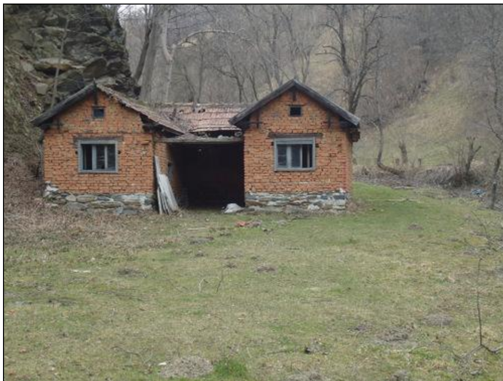
Figura nr. 185 – Aspect privind prezența unei case în stare avansată de degradare în perimetrul trupului nr. 29 (zonă de agrement pe Valea Megheș)
