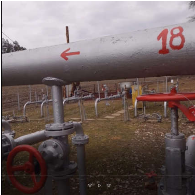
Zona de adaptare a instalatiei tehnologice in vederea montarii unui compresor de camp
