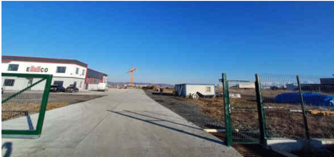
Fig. 5-1 Vedere din partea de V a parcelei către E. În stânga, către N se observă construcțiile EMCO dintr-o fază anterioară de dezvoltare, iar către S, în dreapta drumului de acces se află terenul pe care se vor construi cele patru hale metalice
