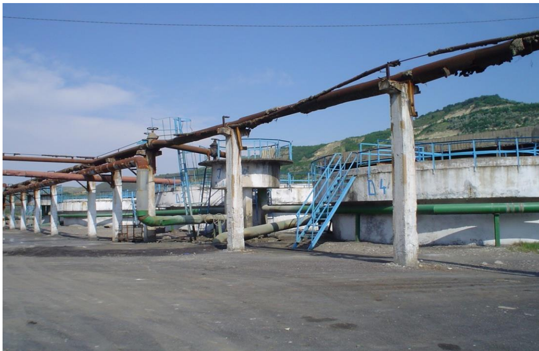
Stația de tratare finală – decantoare suspensionale
