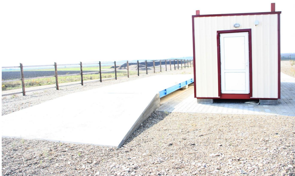
Figură 4. Imagine platforma de cantarire ,container birou in zona de tehnica
